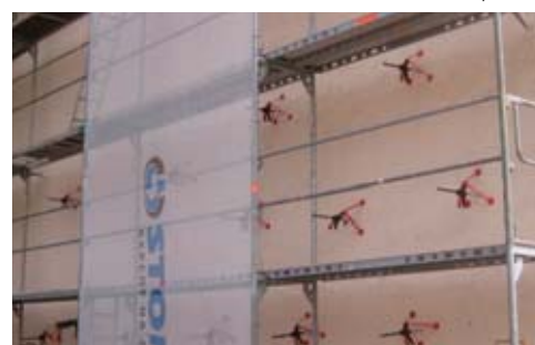
Dokotvenie nestabilného zateplenia
