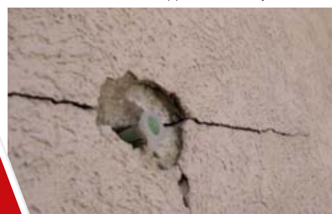
Uvoľnené mechanické kotvy
